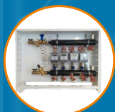
Узлы коллекторные, квартирные станции
